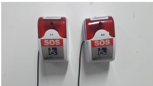
Figura 7: Alarme sonoro e visual no edifício nº 100
