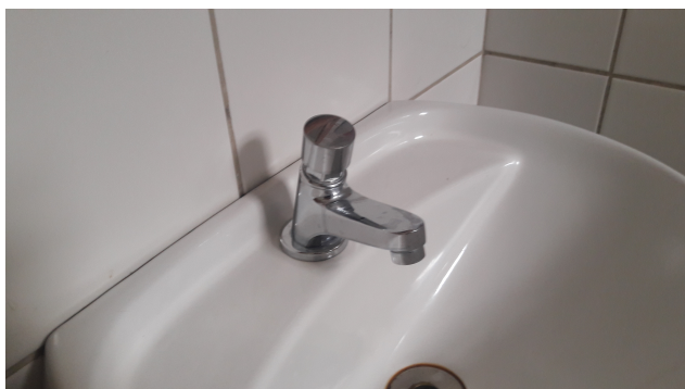
Figura 9: Torneiras do edifício nº 100
